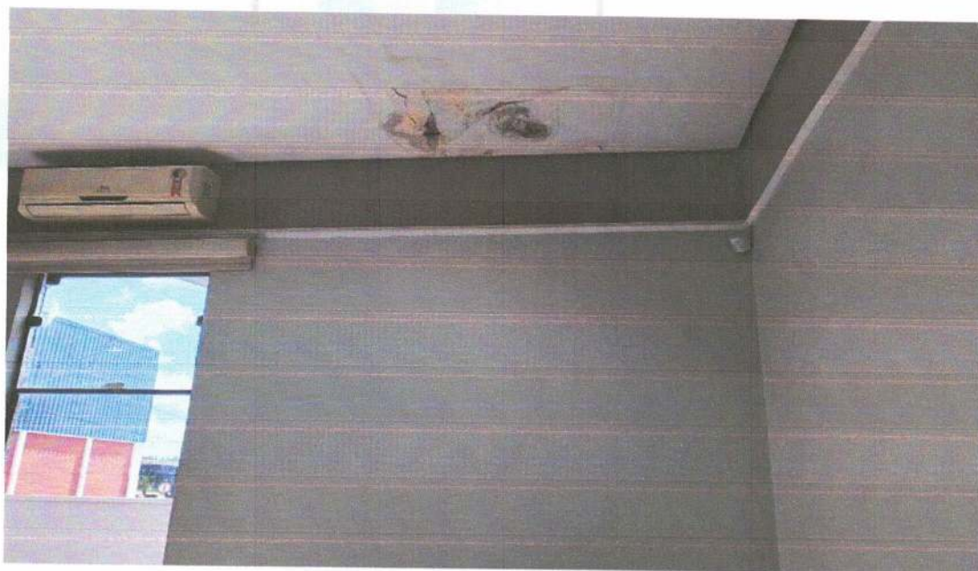
GESSO E ESTRUTURA A SER TROCADA NA SALA DOS VEREADORES
