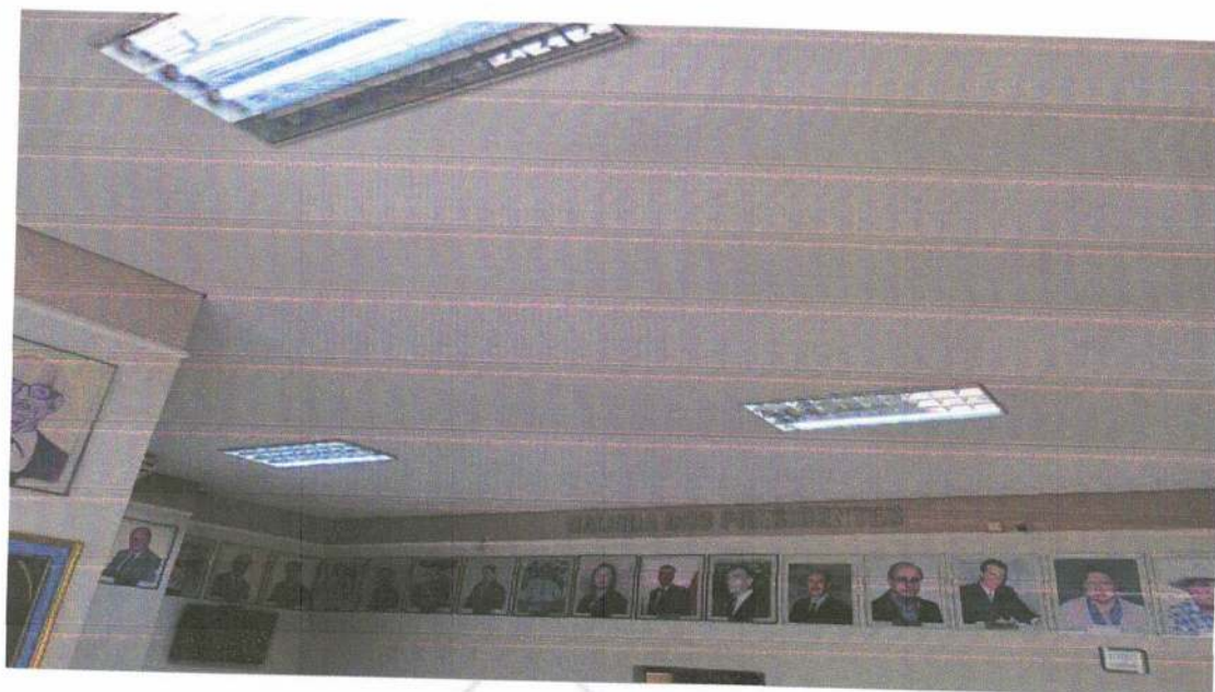
GESSO E ESTRUTURA A SER TROCADA NA RECEPÇÃO
