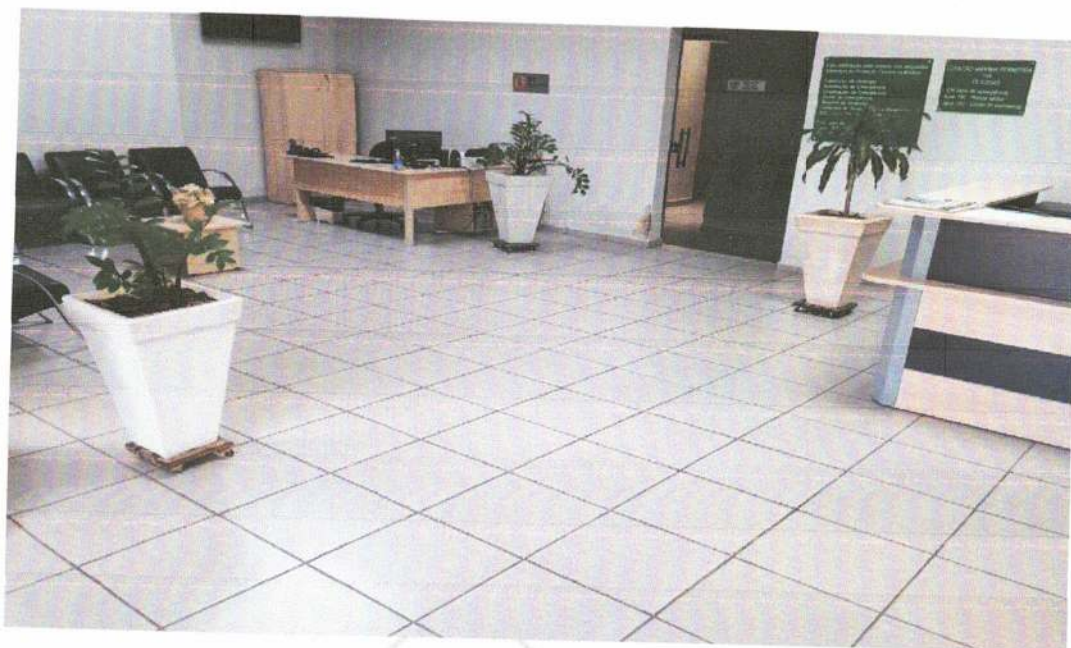
PISO A SER TROCADO
