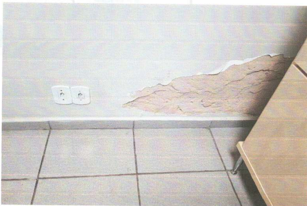
ALVENARIAS A SEREM IMPERMEABILIZADAS SALA DOS VEREADORES
